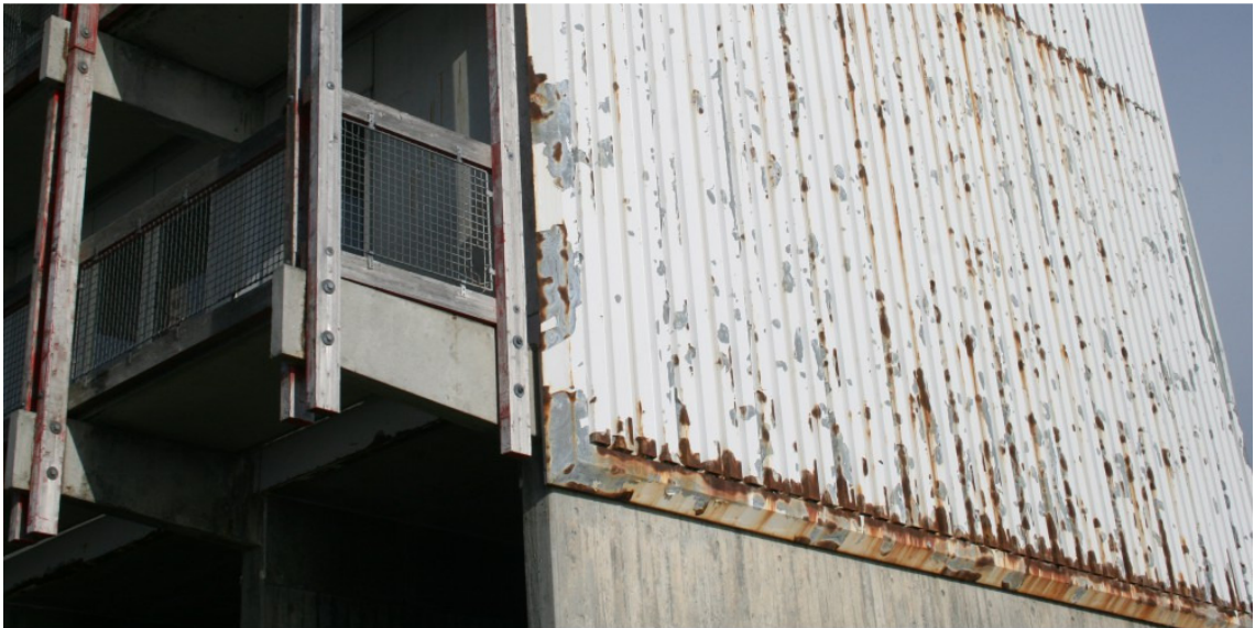
En væsentlig del af malingen fra facaden vil kunne befinde sig i jorden omkring bygningen, Radioffeldet i Nuuk
